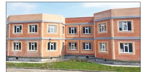
При строительстве детсада выявлено множество нарушений.
