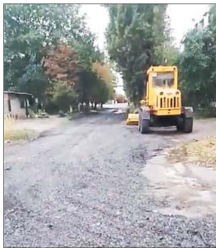
Шахтинцы не дождалась ремонта дороги от водоканала. Фото Сергея Кацына.
