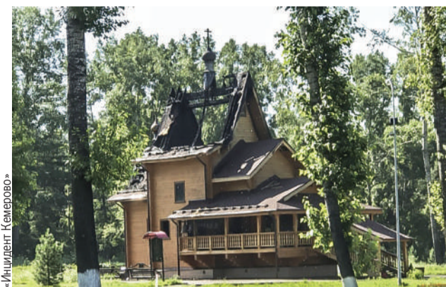
Во время пожара сгорела обрешетка кровли на площади 80 квадратных метров.
