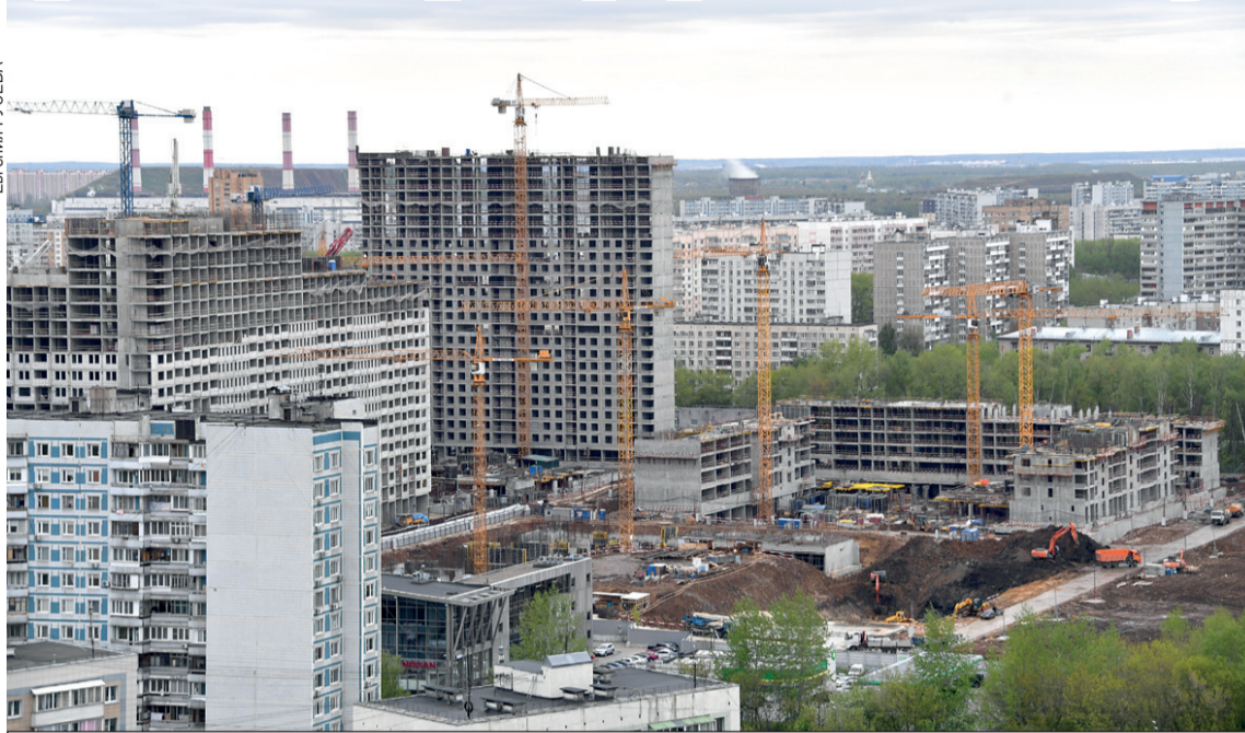
Несущие конструкции, созданные с использованием некачественного сырья, могут обвалиться в любой момент.
