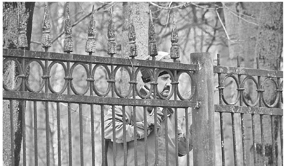
А теперь ее поставили на обновленный забор: ржавую и покривившуюся.
