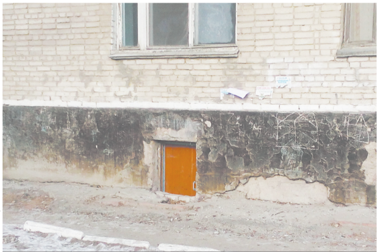
Окошки в подвал кое-как заколочены фанерой.
