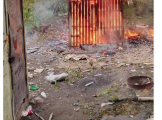
Постройка сгорела полностью.
