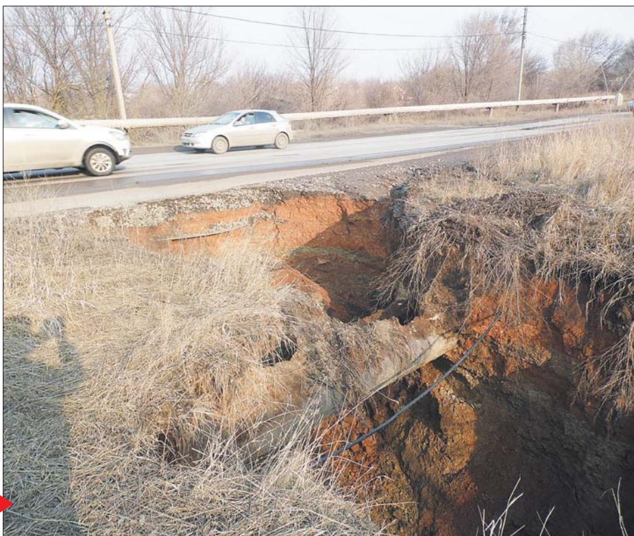
Грунт около дороги рухнул в районе завода РЭМЗ. Фото Анатолия Н.
