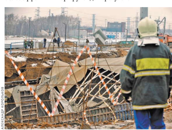
Конструкция тоннеля на Калужском шоссе не выдержала массы жидкого бетона.
