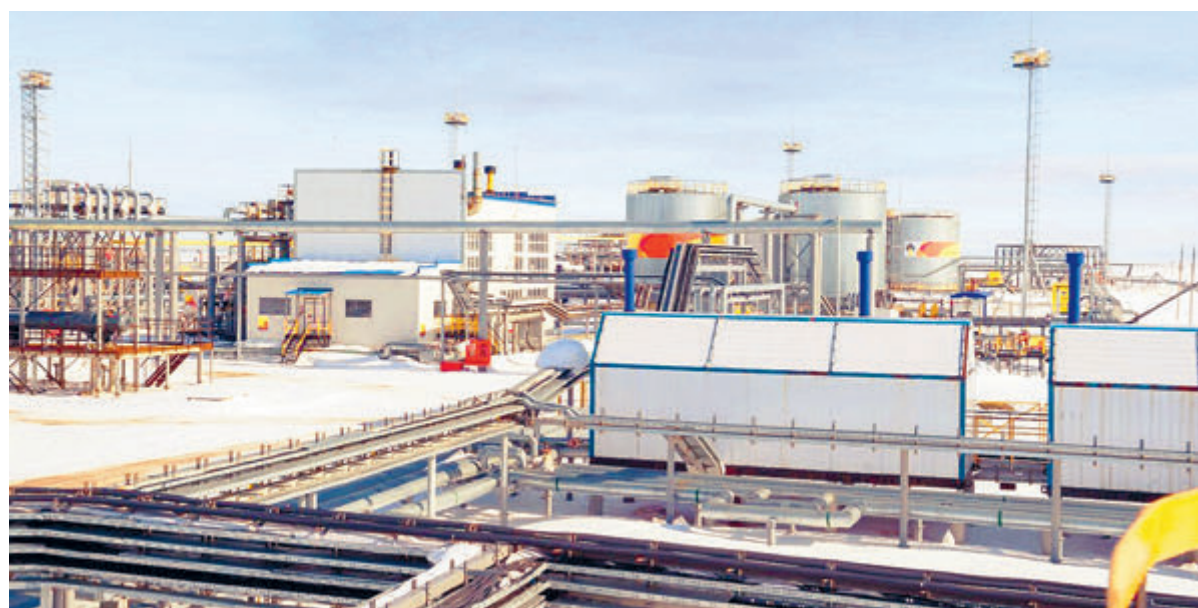
На проекте «Роспан» завершено строительство ключевых объектов первого пускового комплекса установки подготовки газа и конденсата.
