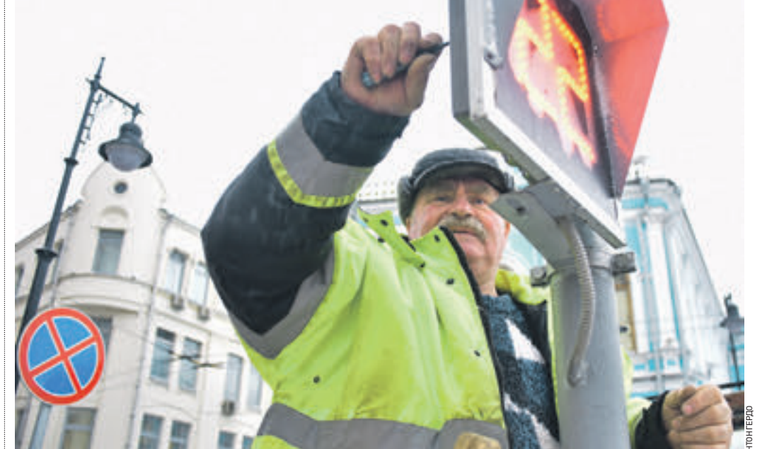
Вчера 12:00 Инженер-электромеханик Центра организации дорожного движения Александр Бородин ремонтирует светофор около станции метро «Лубянка»
