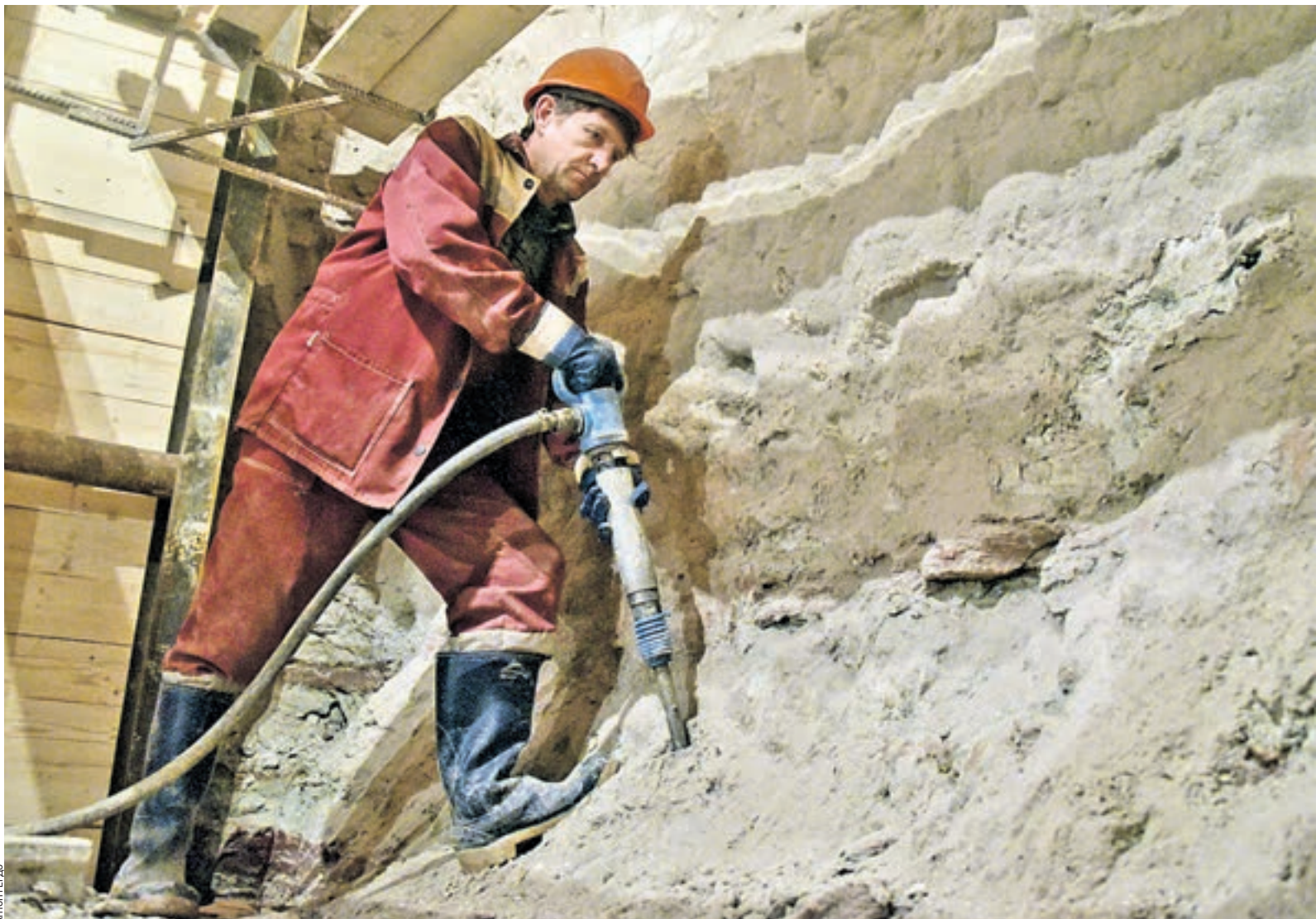
Вчера 14:01 Бригадир проходчиков Александр Круковский с помощью отбойного молотка проходит тоннель станции «Нижняя Масловка» Третьего пересадочного контура. Работы ведутся как вручную, так и с помощью механизмов. Оставшуюся породу грузят в вагонетки и отправляют на поверхность шахты
