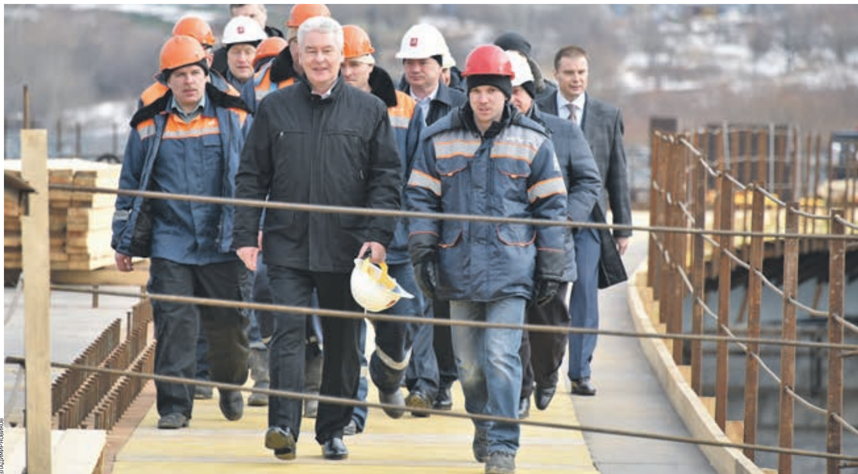
Вчера 11:10 Мэр Москвы Сергей Собянин (в первом ряду в центре) вместе со строителями Андреем Заикиным (слева) и Иваном Потапенко (справа) осматривают участок строительства Северо-Западной хорды между улицами Мосфильмовской и Генерала Дорохова. За мэром справа — глава столичного Стройкомплекса Марат Хуснуллин
