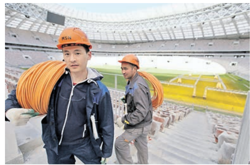
6 мая 13:20 Строители завершают работы на Большой спортивной арене. Уже идет подключение и тестирование оборудования стадиона «Лужники»
