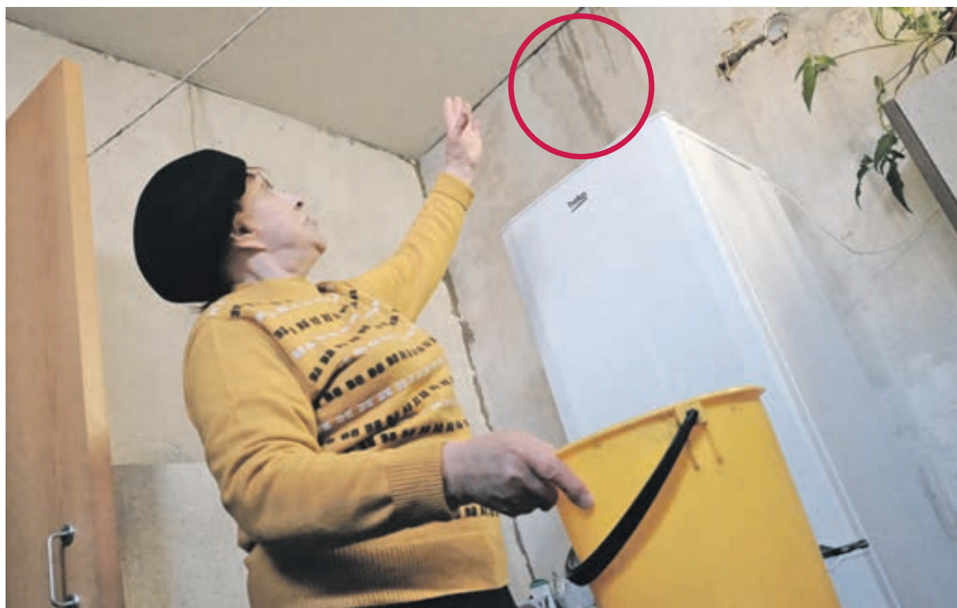
25 февраля 15:44 Жительница дома №3/5 по Серпову переулку Жанна Сулова показывает следы от протечек на стенке балкона
