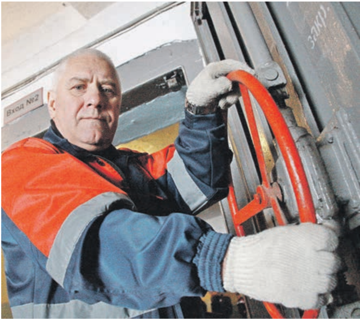
28 февраля 12:24 Специалист по техническому содержанию защитного сооружения Сергей Клочков закрывает защитную дверь убежища весом около тонны
