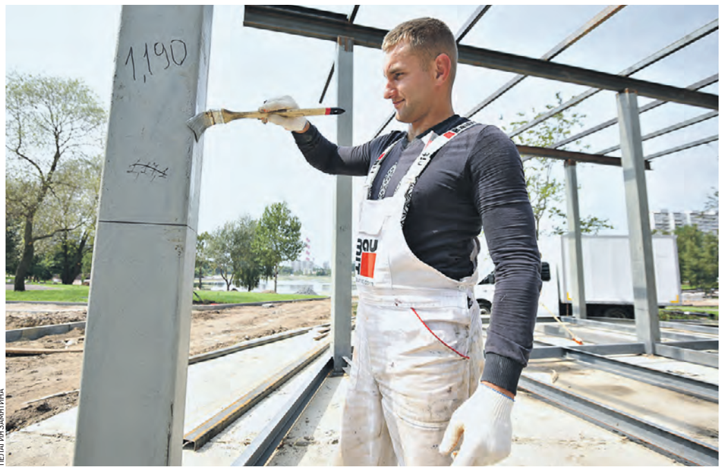
Вчера 12:19 Строитель Евгений Николаичук устанавливает опорную конструкцию для будущего павильона на территории Гольяновского парка
