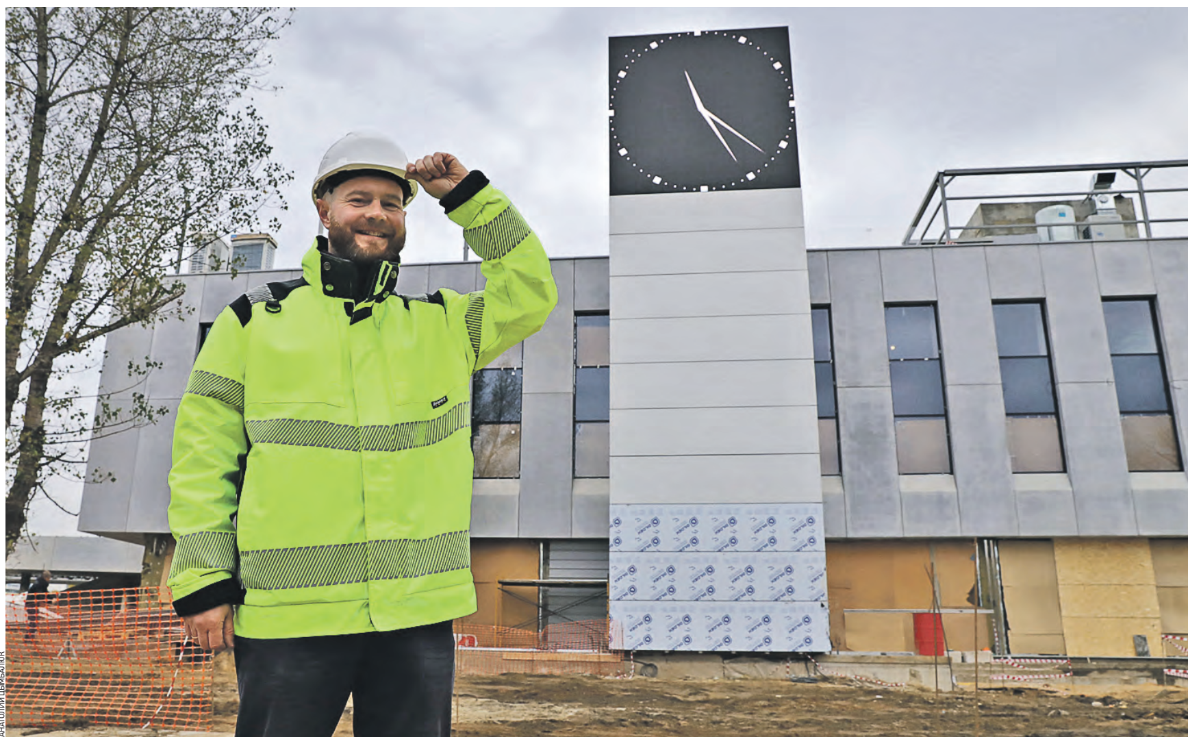
15 октября 11:26 Руководитель строительных работ по реконструкции Южного речного вокзала Эдуард Смирнов на фоне здания, на котором уже установили циферблат и завершили на 95 процентов отделку фасада и кровли
