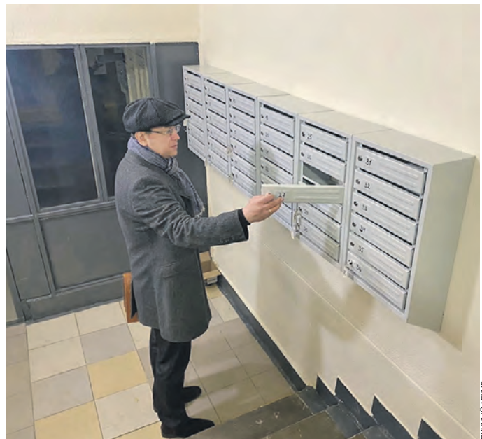
4 октября. Мунципальный депутат Максим Демченков осматривает дом на Каширском шоссе после ремонта
