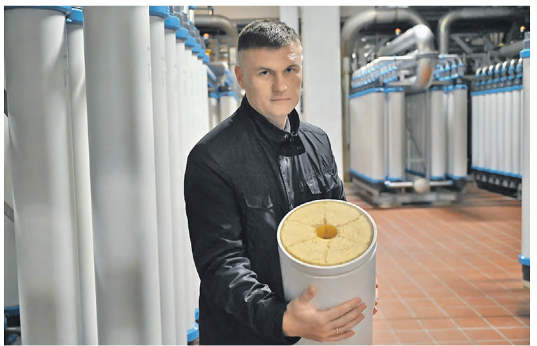
7 октября. Главный инженер Западной станции водоподготовки Дмитрий Чурсинов показывает мембранный фильтр. Фото: Пелагия Замяткина
