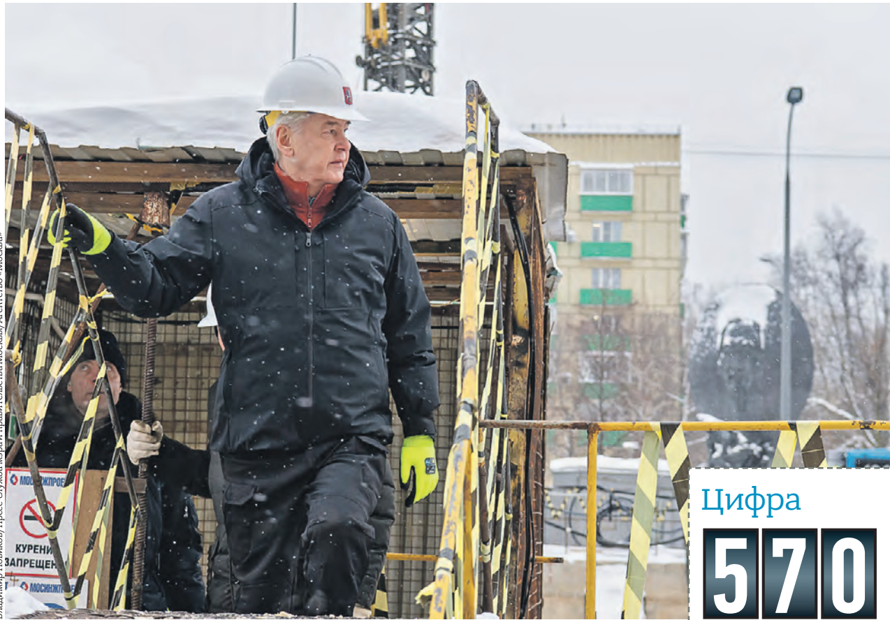
15 декабря. Мэр Москвы Сергей Собянин во время осмотра строящейся станции «Академическая» Троицкой линии Московского метрополитена
